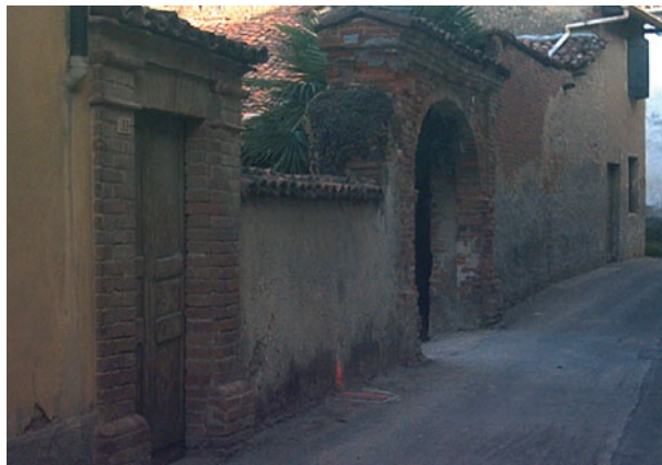
Passerano Marmorito Muro intonacato racchiuso tra portoncino pedonale e ingresso carraio.
