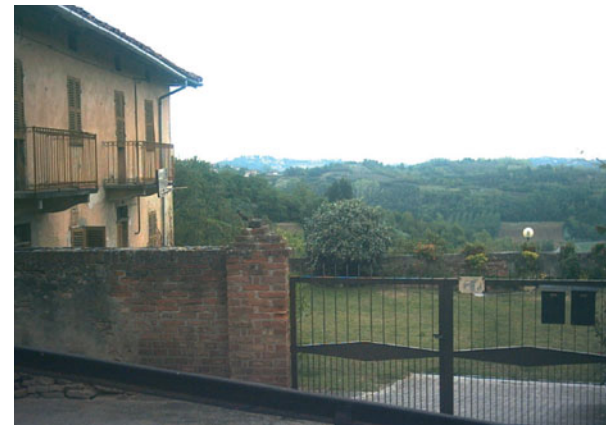
Cinaglio Muro in mattoni a vista, restaurato, con inserimento di cancellone su disegno non tradizionale
