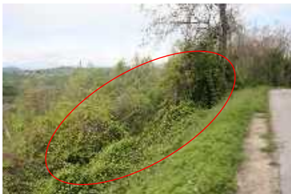
Comune di Moncucco, strada che porta dalla Fraz. Rivalta a San Giorgio di Vergnano. Area invasa da edera e liane.
